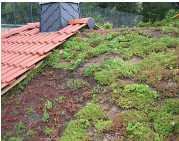
Dach einer massiven Gartenlaube mit herkömmlicher Ziegelerdeckung und extensiver Begrünung. FOTO: WACHTMANN
